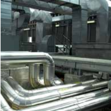
Установка для кондиционирования воздуха
