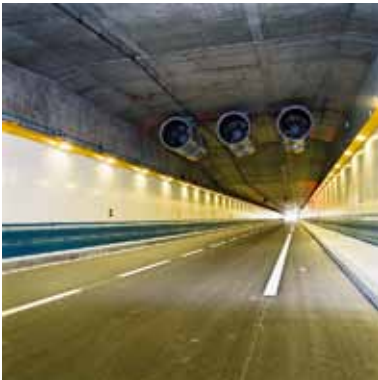
Установка для очистки воздуха
