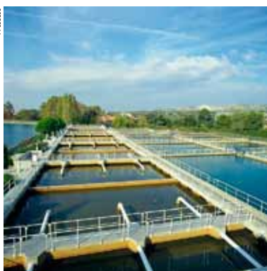
Установка для очистки сточных вод
