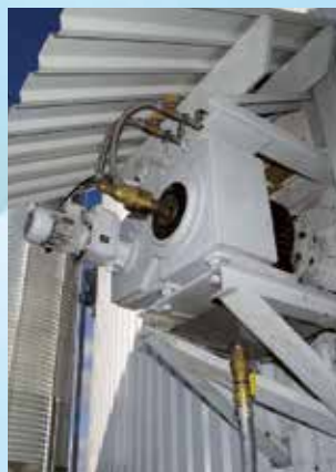
Приводы NORD в биогазовой установке.
