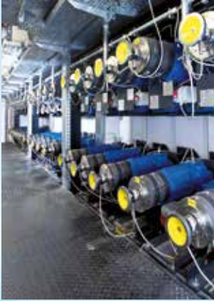
Сценические технические приспособления NORD с двойным тормозом в музыкальном театре в Билефельде.
