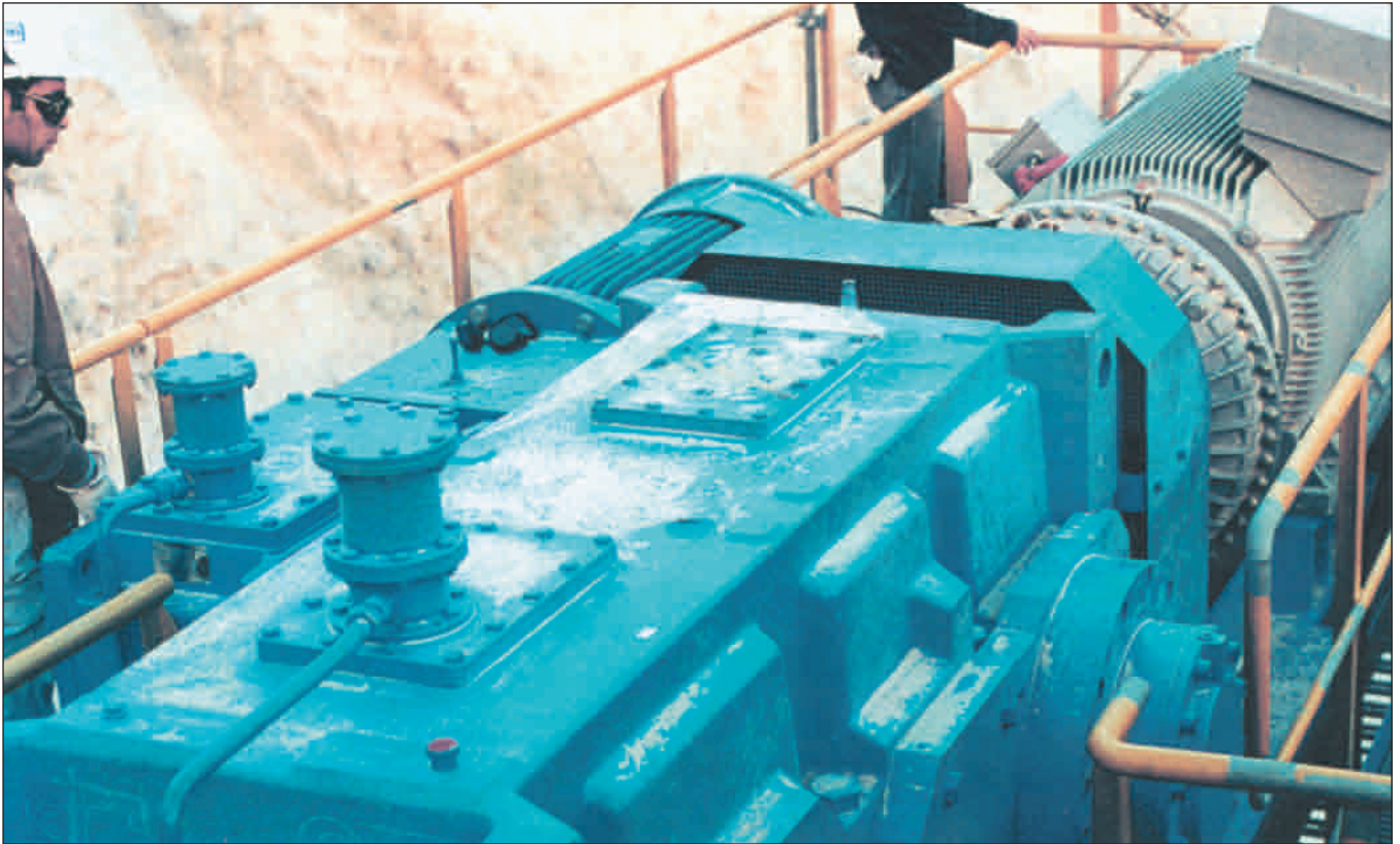
Förderbandantrieb und Hilfsantrieb, Escondida (Chile) Conveyor belt drive and auxiliary drive, Escondida (Chile) Entraînement de convoyeur à bandes avec groupe de virage, Escondida (Chile)
