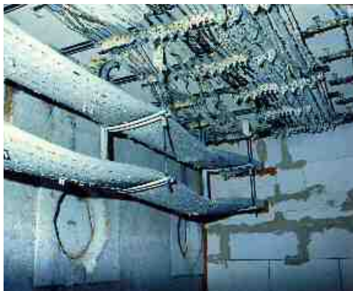
После теста на пожароустойкость.
