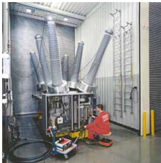
Индивидуальное испытание выключателя ЗАР1 DT 245 кВ
