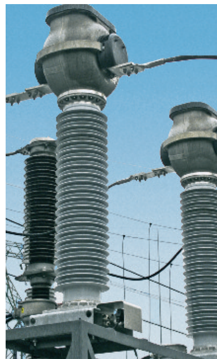
Рис. 41. Газонаполненные трансформаторы тока 145 кВ
