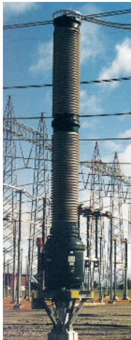
Рис. 43. Газонаполненный трансформатор напряжения 765 кВ
