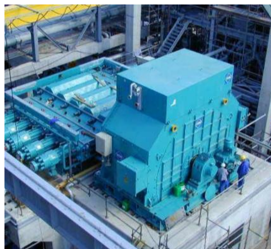
Salzgitter Anlagenbau GmbH, “285-LDPE-Anlage” Базель, Франция
