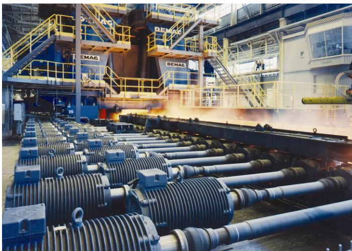
EKO Stahl GmbH Широкополосный стан горячей прокатки, Германия
