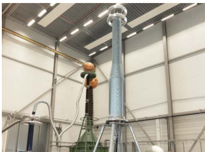
Электрические испытания кабельных муфт на 420 кВ в высоковольтной лаборатории.
